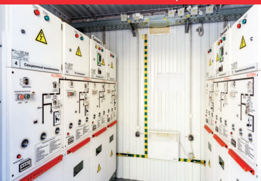
Отсек высокого напряжения
