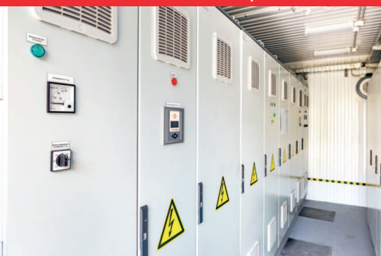
Отсек низкого напряжения
